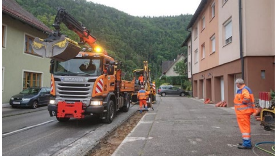
Abflachung der Gehsteigkante im Bereich Unterm Hals vor der Wohnhausanlage.
